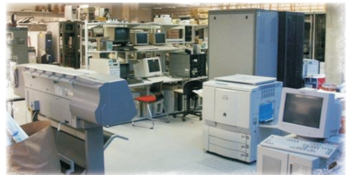
Im Systemraum: Drucker, Rechner, Steuergeräte
