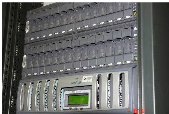
Teilcluster im Systemraum des RZ
