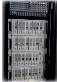
Server mit Plattenspeicher
