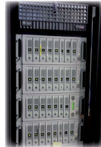
Server mit Plattenspeicher
