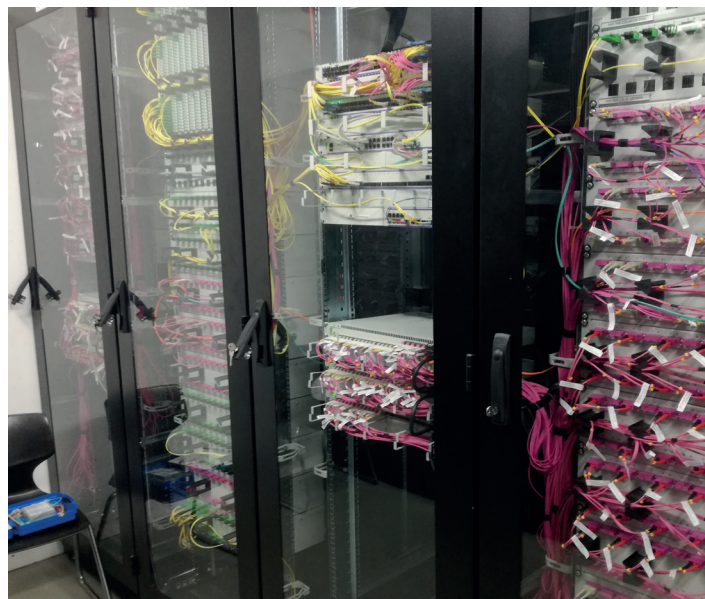
Serverraum im TAO-Gebäude
